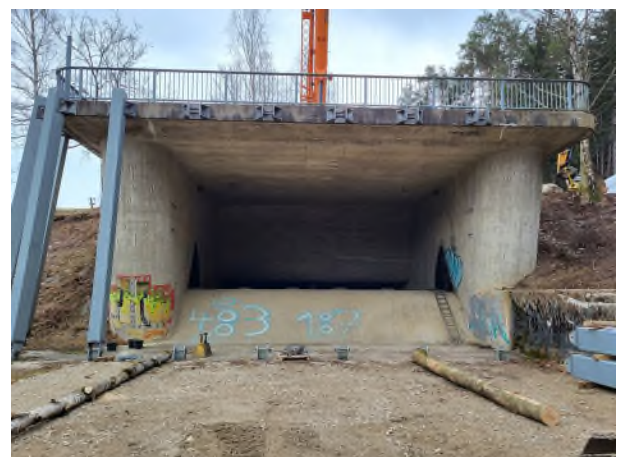
Abbildung 5: Hier, in der Hochwasserentlastung des Surspeichers ist die Fischbauchklappe eigentlich eingebaut. Links zu sehen sind einige der vorgeschalteten Wildholzrechen. Foto: Wasserwirtschaftsamt Traunstein
