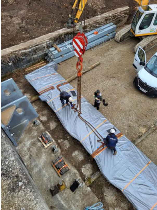
Abbildung 1: Zwei Arbeiter befestigen die in Folie verpackte Fischbauchklappe an zwei Stahlseilen. Foto: Wasserwirtschaftsamt Traunstein
